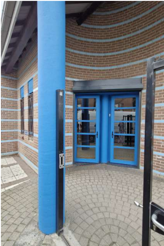
Rénovation des portes et de la colonne à l'entrée du restaurant scolaire Louise Michel, par les services techniques de la ville : 105,02€
